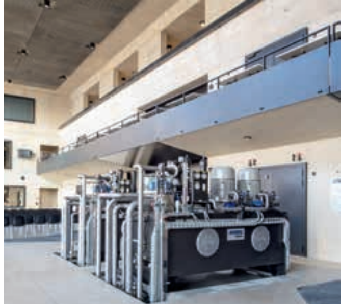
Groupe de générateurs: le local des machines peut également servir d'auditorium.
