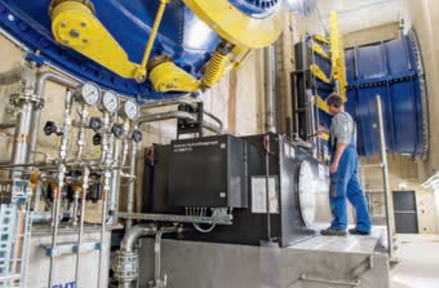
Au cœur de la force: deux turbines bulbes fournissent de l'électricité à plus de 30 000 ménages.
